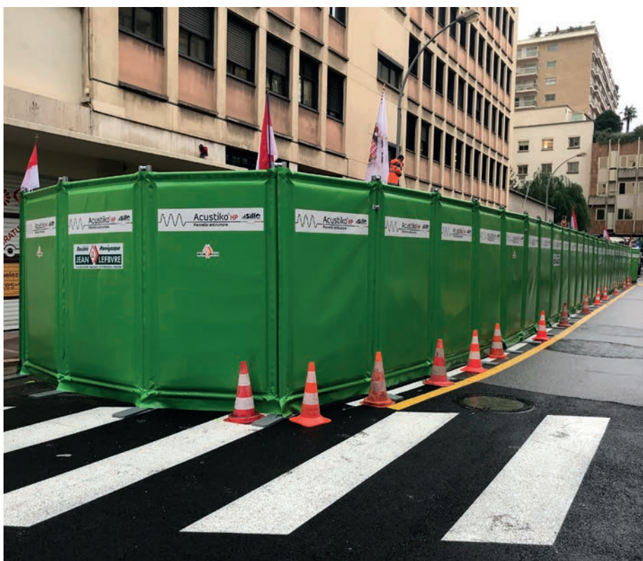
Ecran acoustique répondant aux demandes de gestion, contrôle et réduction du bruit du aux chantiers.
