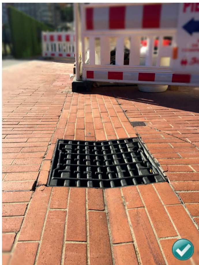
Avaloir sans poussières ni rejets à proximité.
