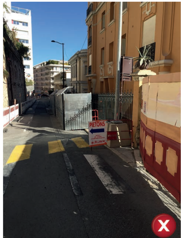
Cheminement piéton qui présente des défauts dans son installation.
