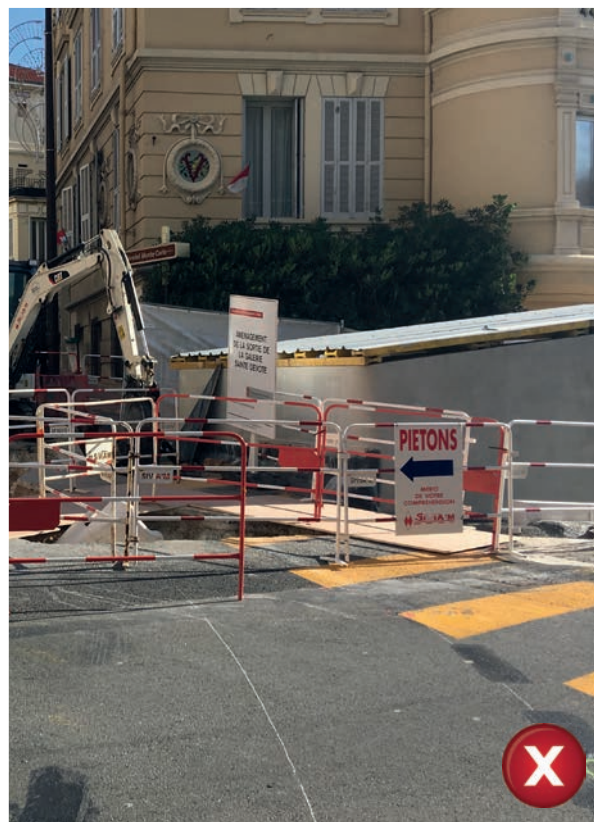
Cheminement piéton mal encadré et mal indiqué.
