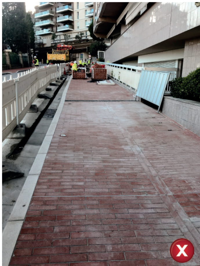
Avaloirs non protégés malgré la poussière du chantier.
