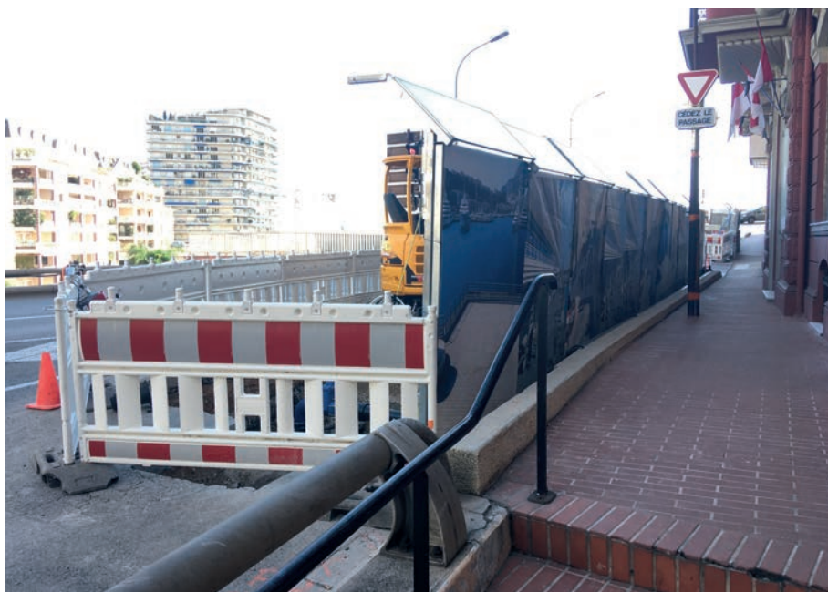
Ecran acoustique répondant aux demandes de gestion, contrôle et réduction du bruit du aux chantiers.
