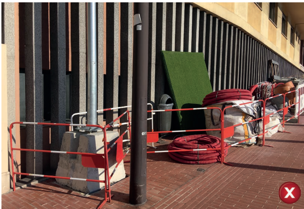
Chantier encadré par des barrières tubulaires non occultantes, sentiment de désorganisation.
