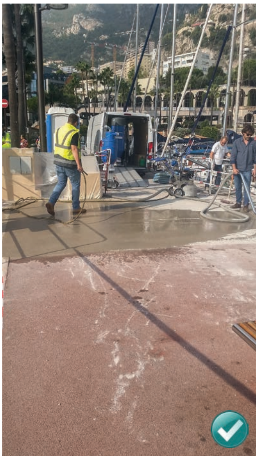
Aspiration mécanique de rejets nocifs pour l'environnement.
